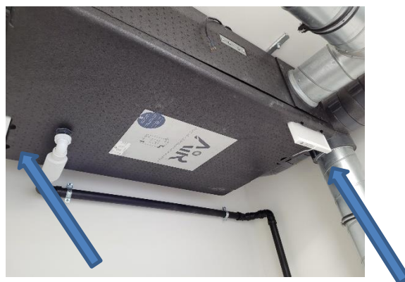
plaats van de filters
