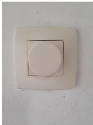
3 standen schakelaar - woontype 5/7 de cijfertjes staan bovenop de draaiknop
