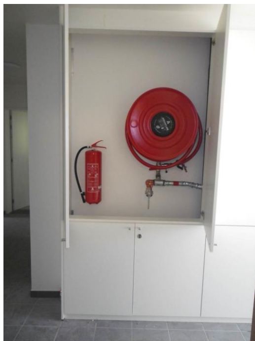
Brandblusser en brandslang in de wandkast
