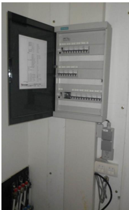
Splitter ter hoogte van elektrische verdeelbord
