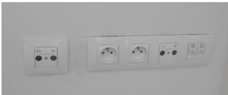
Aansluitingen in de woonkamer
