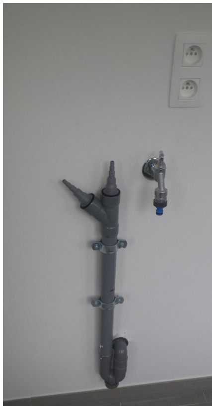
Aansluitpunt wasmachine en droogkast
