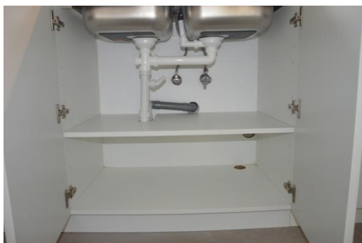
Stopcontact met gat in bodempaneel
