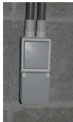
Individuele schakelaar en stopcontact
