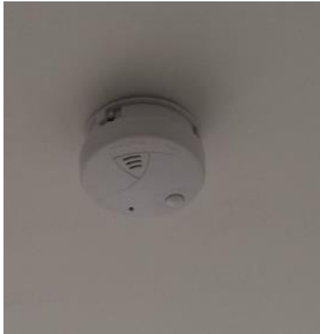
Rookmelder in het appartement
