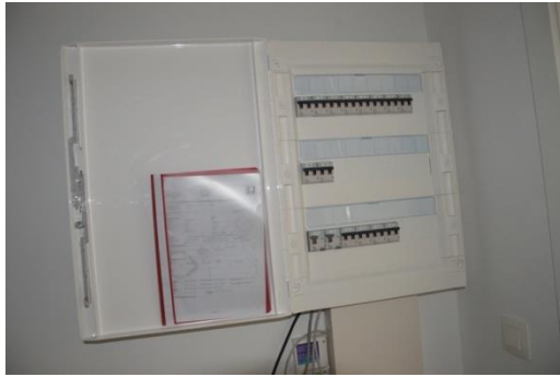
Zekeringsbord elektriciteit met elektrisch schema
