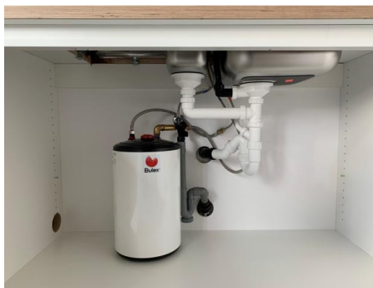
Boiler en veiligheidsventiel
