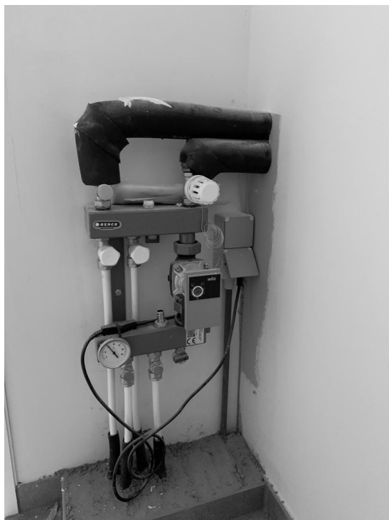
Collector voor vloerverwarming in berging
