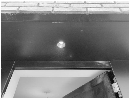
Buitenverlichting aan voordeur (Enkel bij Korbeekhof 17)
