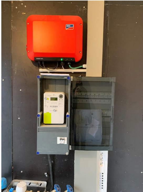
Elektriciteitsmeter (links), elektrisch bord (rechts), omvormer voor zonnepanelen (boven)
