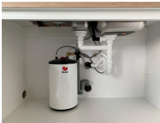
Boiler en veiligheidsventiel
