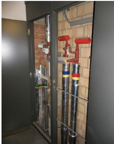
Water- en warmtetellers
