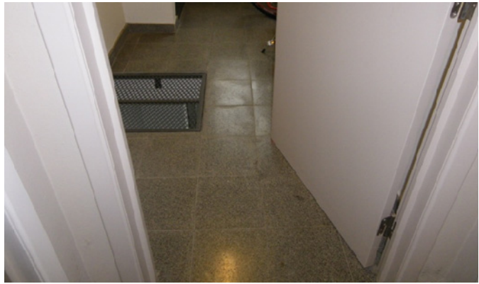
Toegang tot vluchtladder via branddeur (einde v/d gang)
