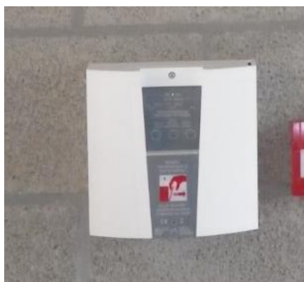
Brandcentrale - enkel voor brandweer
