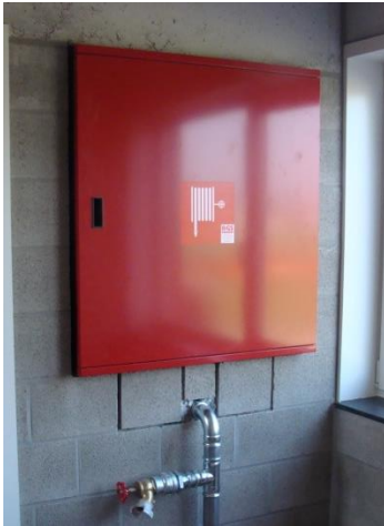
Brandslag in metalen kast
