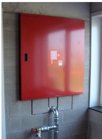
Brandslag in metalen kast
