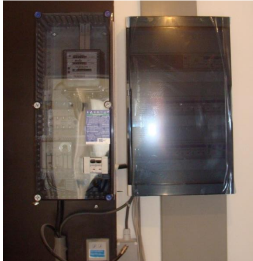
Links: elektriciteitsteller - Rechts: elektrisch bord
