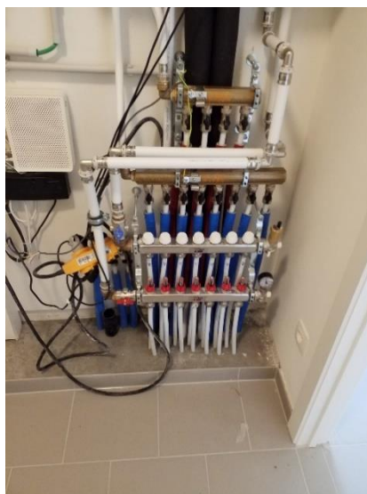
collectoren van de vloerverwarming
