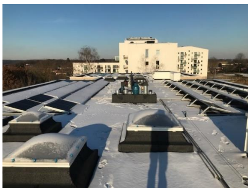
zonnepanelen op het dak
