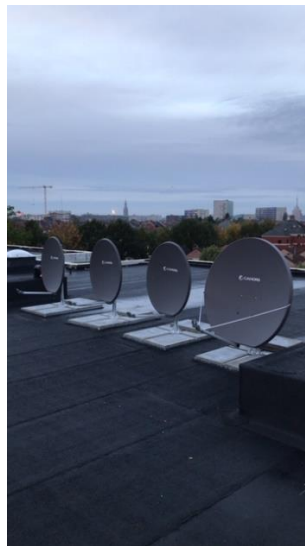
satellietantennes op het dak
