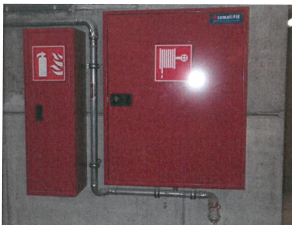
Brandblusser en brandslang in metalen kast
