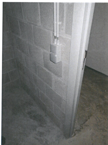
Individuele schakelaar en stopcontact
