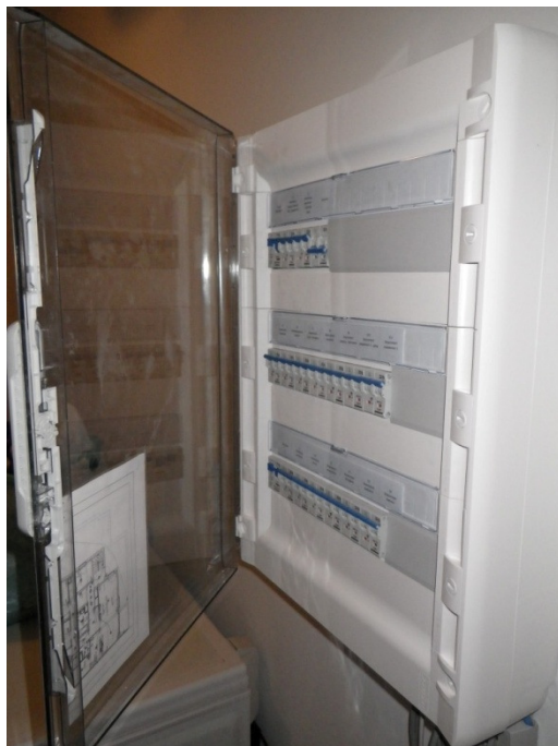
Zekeringsbord elektriciteit met elektrisch schema
