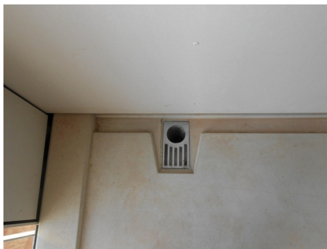
Regenwater afvoer van het terras
