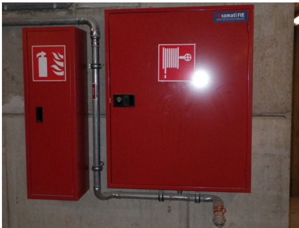
Brandblusser en brandslang in metalen kast
