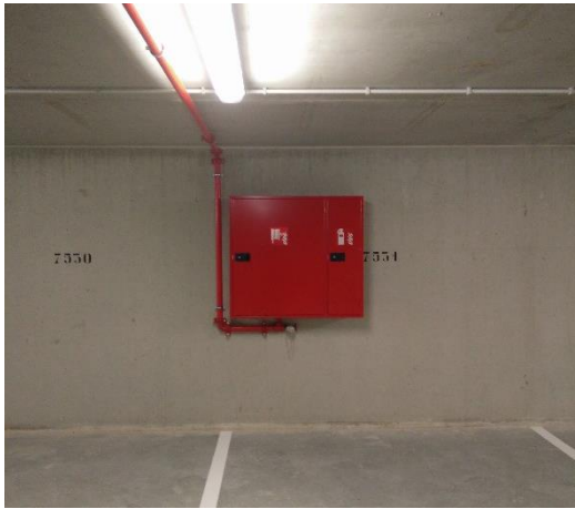
Brandblusser en brandhaspel in garage
