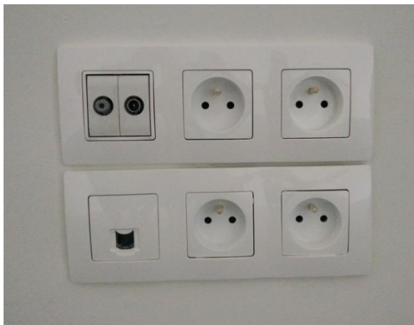
Aansluitpunt satelliet (linksboven)
