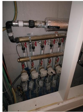
Kast met meters van de centrale verwarming
