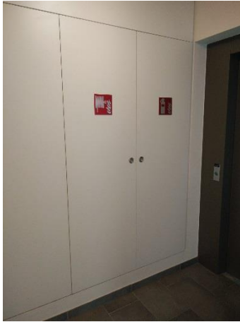
Brandblusser en brandhaspel in gangen
