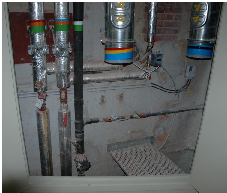
energiemeter, waterteller, aansluiting distributie/telefoon
