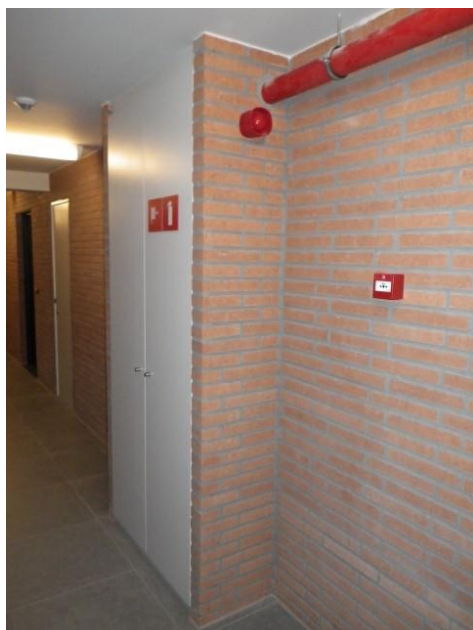
Sirene en brandmeldingsknop
