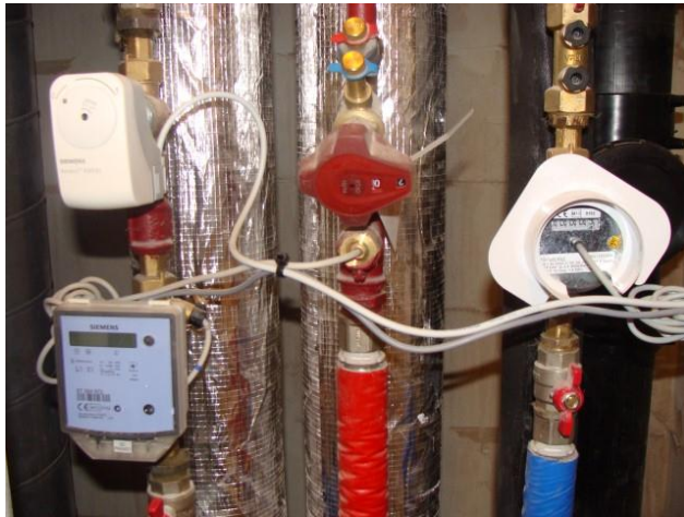
Water- en warmtetellers
