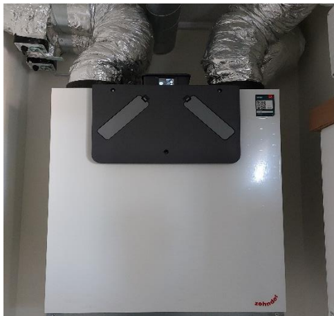
Ventilatie-unit (met vooraal de grijze kleppen met filters).
