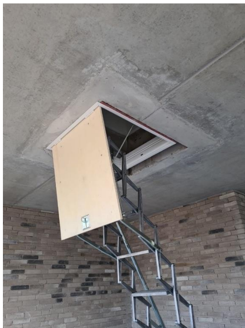
Toegangsluik tot dak - enkel toegang voor technisch personeel
