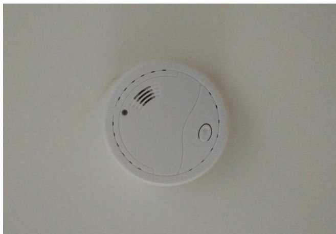
Rookmelder in het appartement
