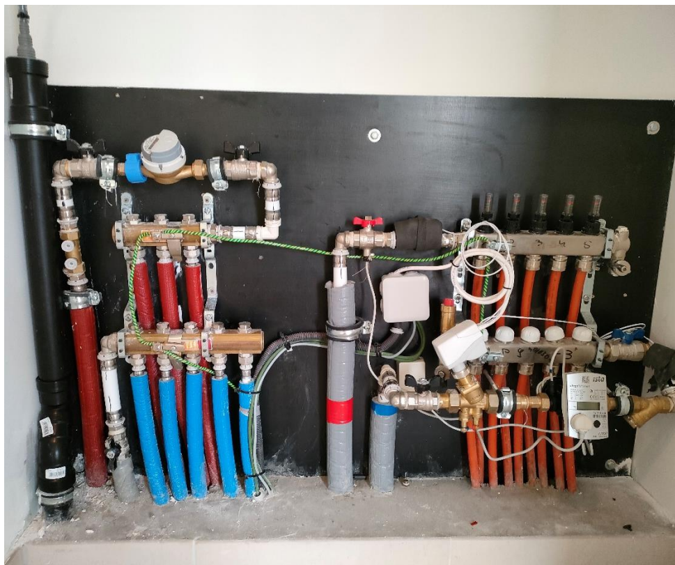
Koudwatermeter en warmtemeters voor warm water en centrale verwarming
