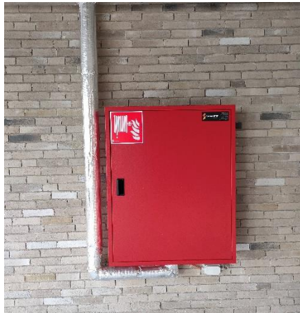
Brandblusser en brandhaspel op passerelle
