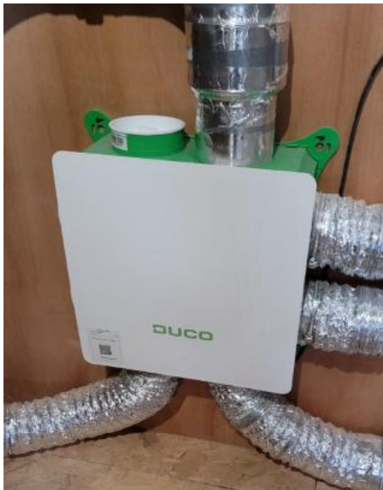
ventilatie-unit op zolder
