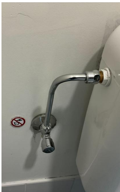
Linkse aansluiting met regenwater
