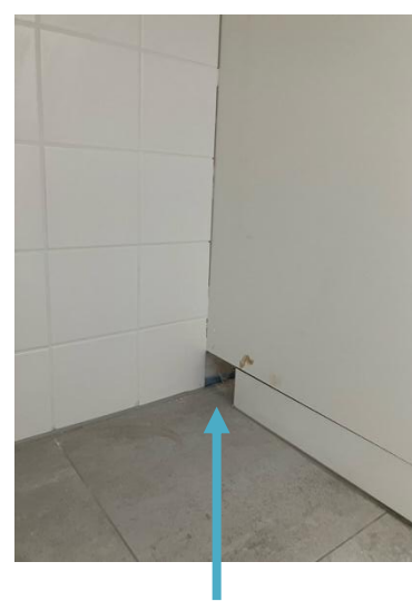
doorvoer elektriciteitskabel afwasmachine
