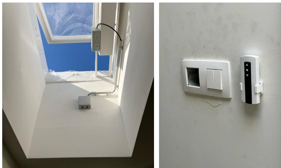
Dakkoepel en afstandsbediening
