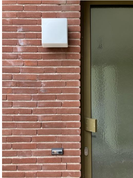
Deurbel en buitenlicht naast voordeur
