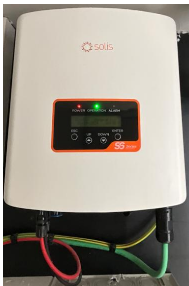
Omvormer voor de zonnepanelen
